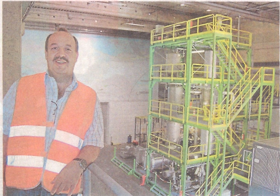
Jörn Düsterloh vor der neuen Anlage, in der am Entsorgungszentrum in Ennigerloh Kraftstoff aus Müll hergestellt wird. Der Probe-Betrieb läuft bereits. Gestern wurde die erste 7000-Liter-Charge ausgeliefert.
